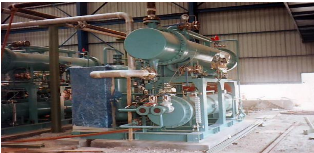
Gambar 5.2 After Cooler dan Refrigerator pada Air Sparation Plant
